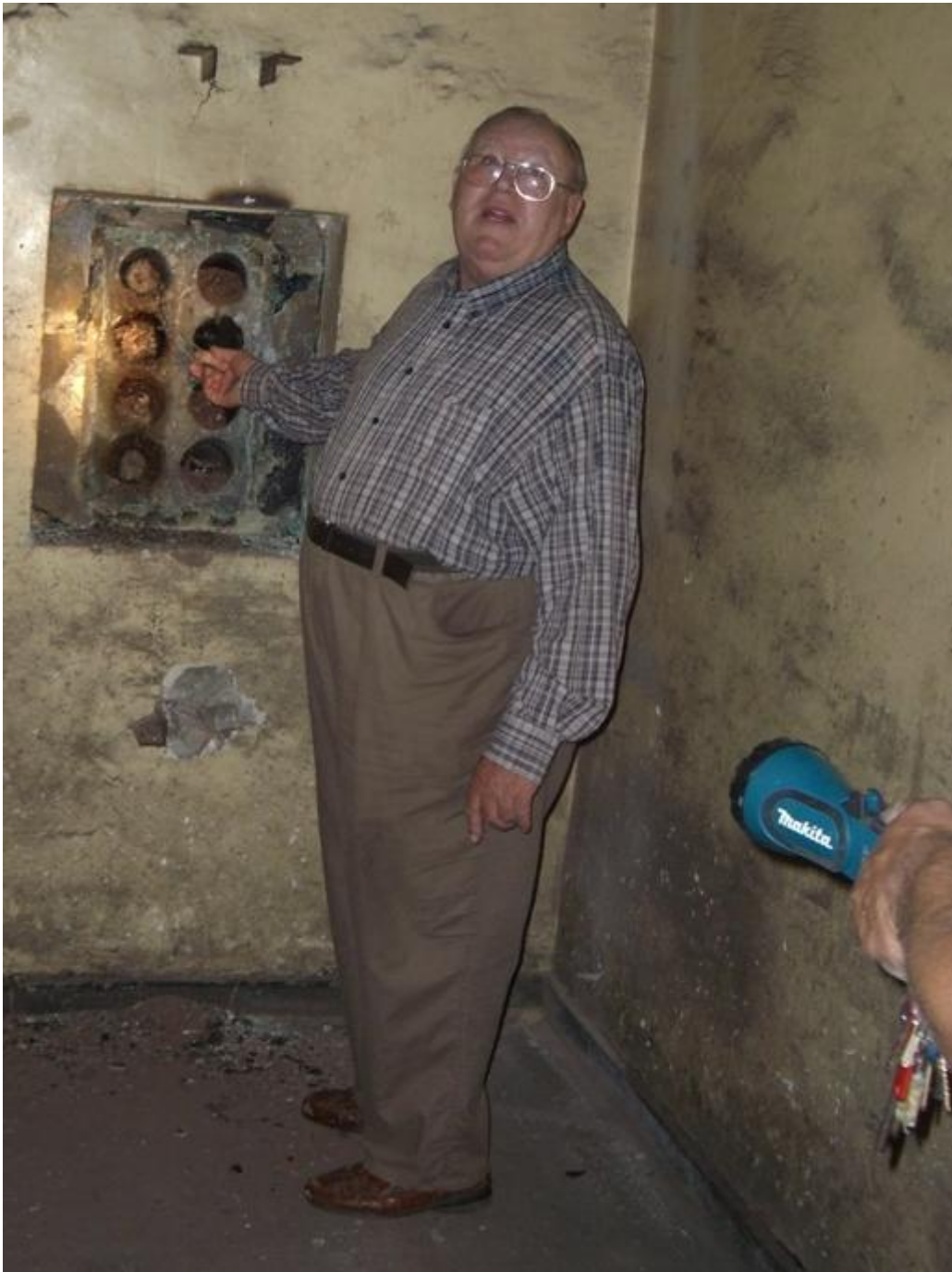
Heino Arnold zeigt die armdicken Öffnungen in der Kellerwand der Verteilerstationen, in welchen die Kabel für die Aufnahme und Weitergabe der Signale verlegt waren.
